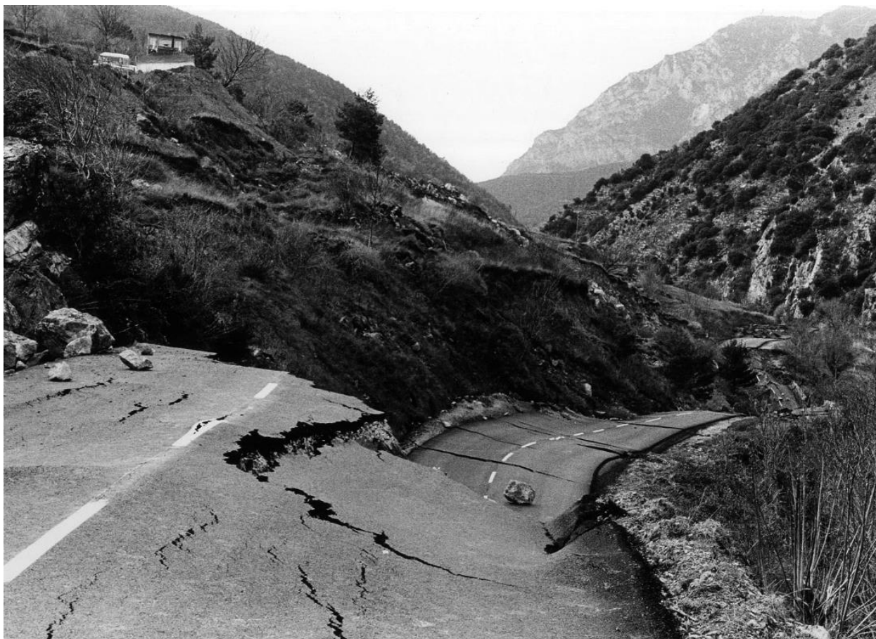
Figura A2-6. Danys a la carretera C-1313 provocats pel lliscament del Pont de Bar la nit del dia 7 al 8 de novembre de 1982. Autor: desconegut.
