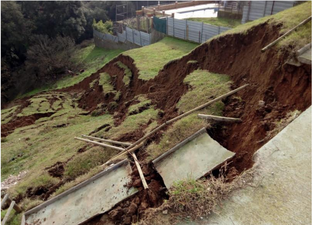
Figura A2-2. Cicatriu de capçalera i esquerdes de tracció d'un lliscament rotacional de mida M4 ocorregut al veïnat de Can Ram de Sant Pere de Vilamajor, durant l'episodi de pluges de gener de 2020. Font: ICGC.
