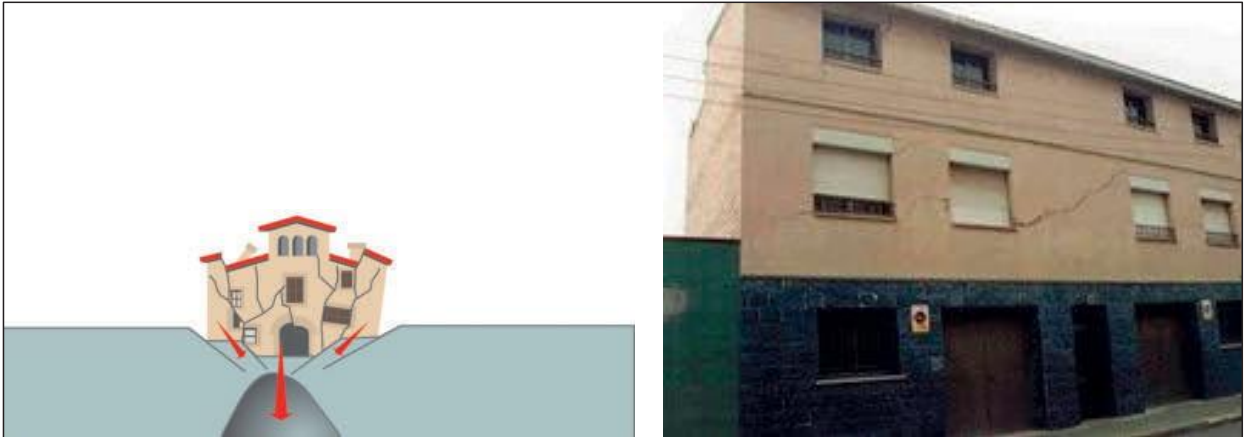
Figura 5. Tall esquemàtic d'un enfonsament del terreny (subsidiència i col·lapse). Fotografia: Esquerdas a l'edifici que hi havia al número 20 del Carrer de València del Barri de l'Estació de Sallent provocades per la subsidiència del terreny a causa d'una explotació minera, any 1997. Font: ICGC.
