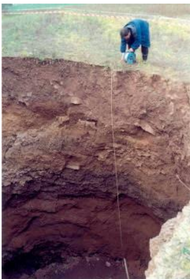
Figura A4-4. Enfonsament de col·lapse en sòl cohesiu al sector dels Joncarets de Sùria. Font: ICGC.
