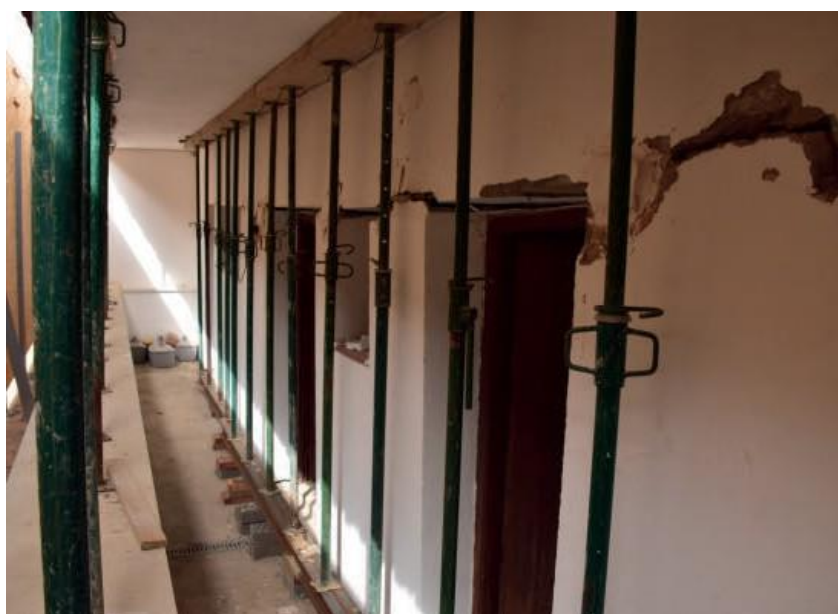
Figura A4-7. Patologies per enfonsament en les instal·lacions de la piscina municipal de la Sentiu de Sió (Noguera), el maig de 2023. Font: ICGC.
