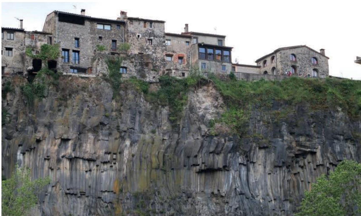
Figura A1-12. Cicatrius de caigudes a la part superior de l'escarpament que afecten el marge posterior d'alguns habitatges de Castellfollit de la Roca. Font: ICGC.
